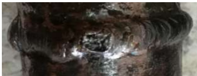
Фото 1 – Скопление пор в металле шва
