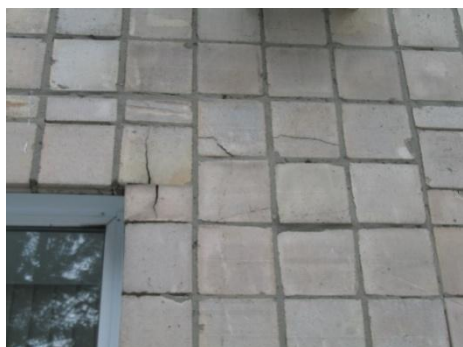
Рисунок 1 –Трещины в облицовочной плитке
