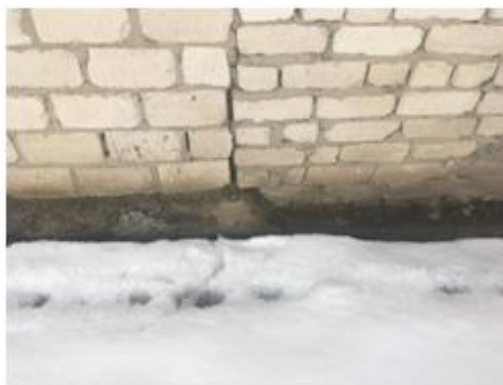
Рисунок 1– Разрушение нижнего ряда кладки несущих стен
