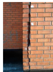
Рисунок 2 – Вертикальная трещина в лицевом слое, ул. Привокзальная 7, г. Барнаул
