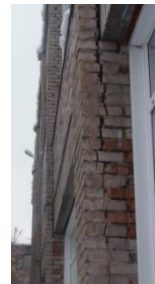
Рисунок 2 – Простенок первого этажа, поврежденный трещинами
