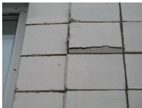
Рисунок 2 – Выпучивание и отслоение плитки
