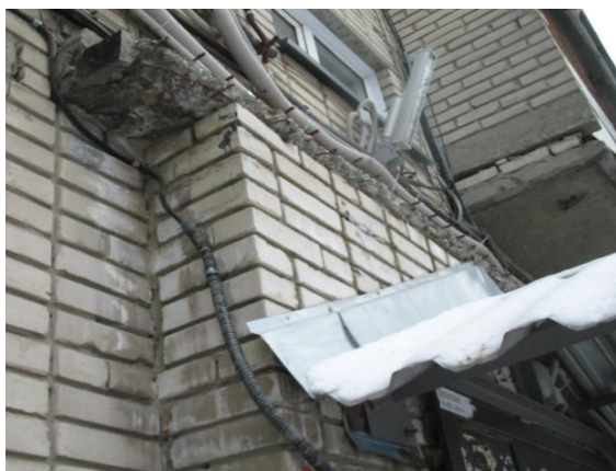
Рисунок 1 – Козырьки подъезда № 1: сверху железобетонный после демонтажа, ниже – вновь устроенный металлический. На стенах видны следы замачивания
