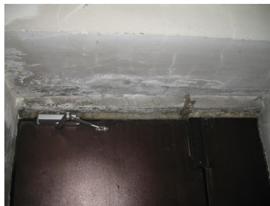
Рисунок 2 – Следы замачивания отделки перемычек дверного проема в наружной стене в подъезде № 4
