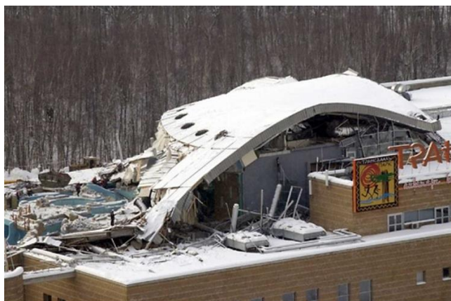
Рисунок 1 – Обрушения покрытия аквапарка «Трансвааль парк»
