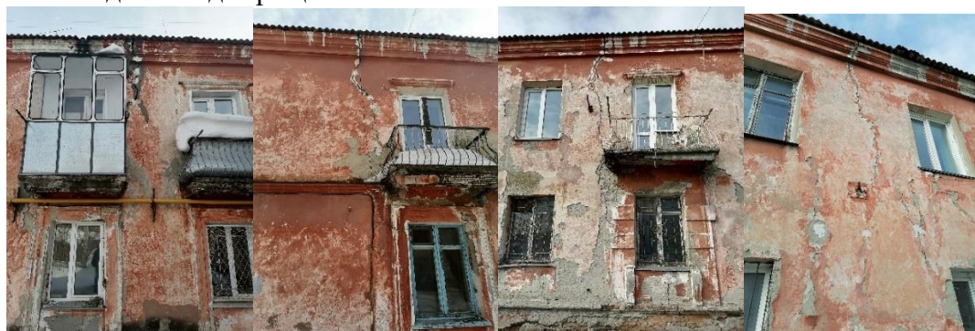
Рисунок 1 - Дефекты кирпичной кладки
