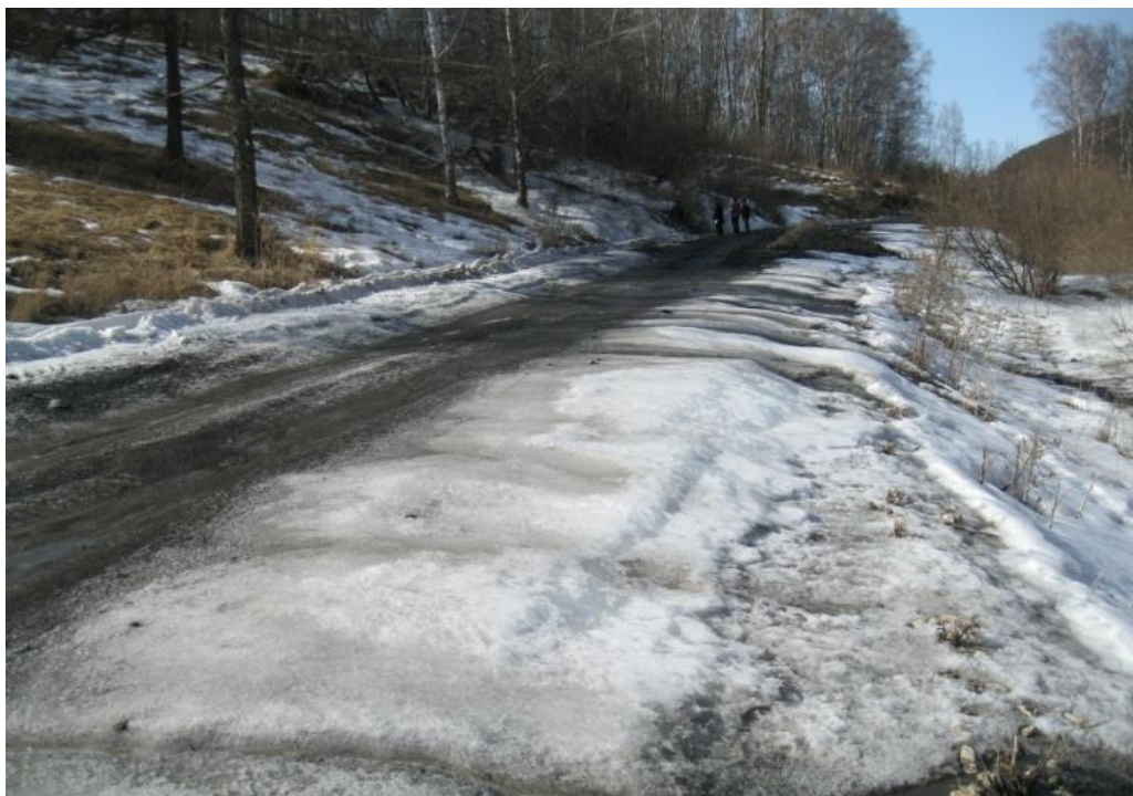
Рисунок 1 - Наледь, образовавшаяся на участке автомобильной дороги «Быканов мост – Солоновка – Солонешное – граница Республики Алтай»
