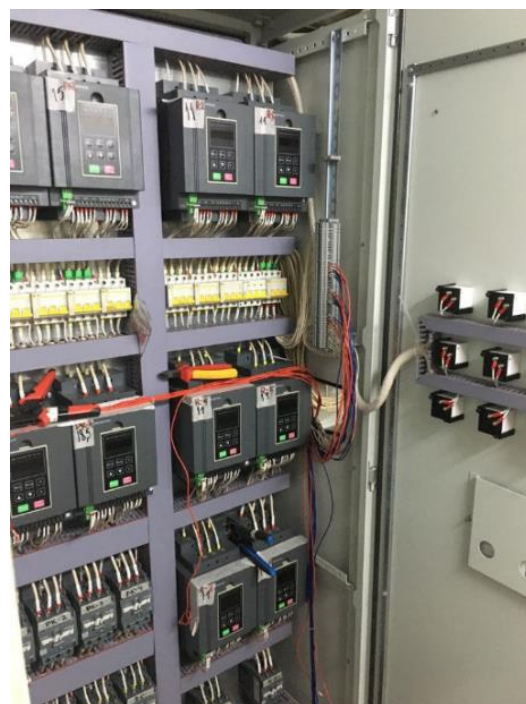
Рисунок 5 - Вид силового шкафа оборудования после модернизаций
