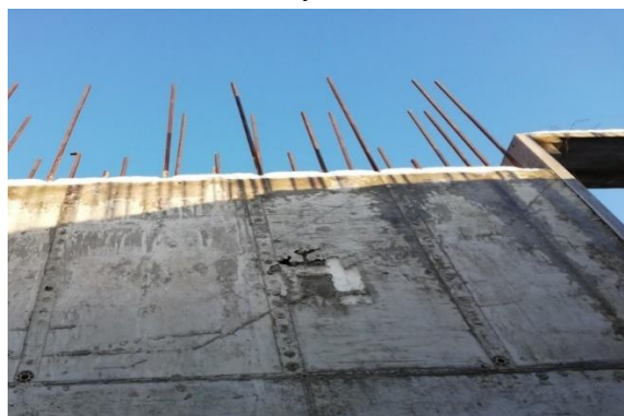
Рисунок 7 – Низкое качество выполнения строительно-монтажных работ
