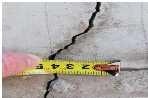
Рисунок 4 – Вертикальная трещина в колонне
