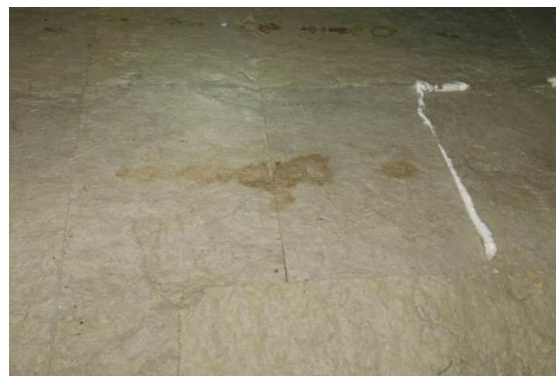
Рисунок 6 – Следы протечек на утеплителе чердачного перекрытия
