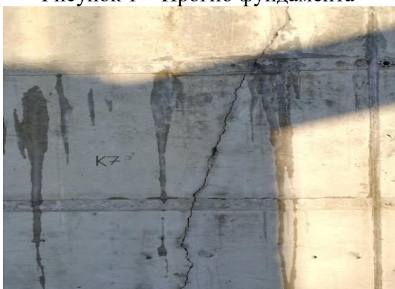
Рисунок 3 – Вертикальная трещина в колонне
