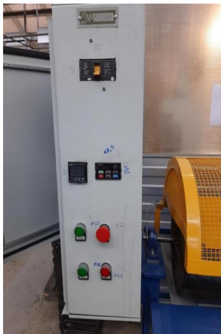
Рисунок 2 - Фотография шкафа управления автоматизированным электроприводом
