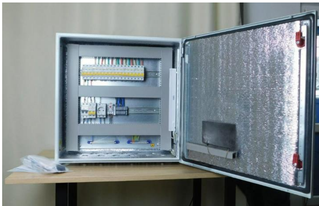
Рисунок 3 – Электрический шкаф с вмонтированным электрообогревателем
