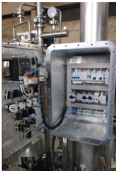
Рисунок 1 – Шкаф управления вакуумно-выпарной установкой
