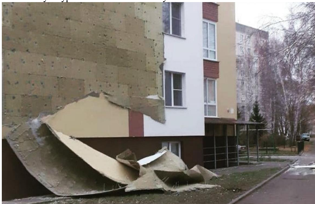
Рисунок 3 – Обрушение штукатурного слоя фасада жилого дома в пос. Южный
