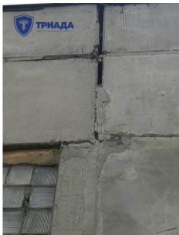
Рисунок 3 – Разрушение заполнения межпанельных швов
