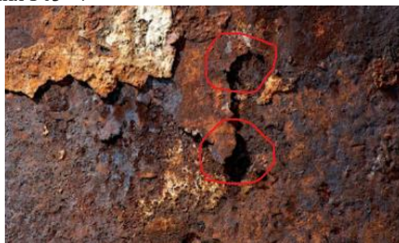
Рисунок 1 – Тест-объект под воздействием коррозии
