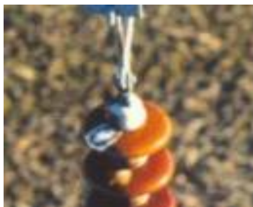
Рисунок 1 – Разрушение юбки изолятора
