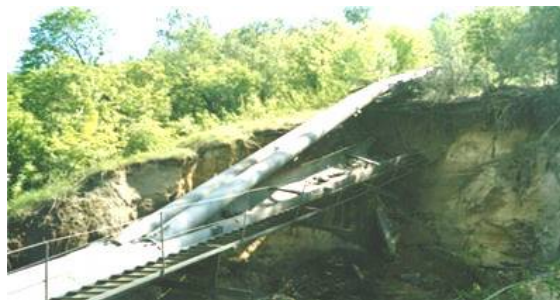
Рис. 3. Оползень на участке восточного спуска трассы ГЗУ ТЭЦ-2. Разрушен железный лоток, деформация рабочих ниток золотпровода
