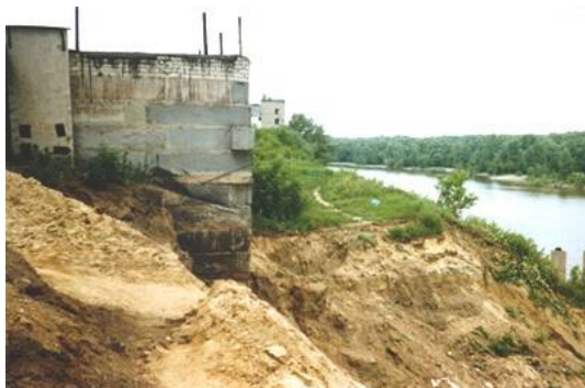
Рис. 5. Оползень на участке ГПСК-638, верхняя часть склона
