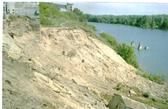
Рис. 4. Оползень на участке бывшей ОМФ (центральный фланг)
