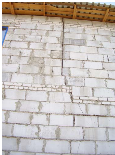
Рис. 3. Трещина на боковом фасаде здания
