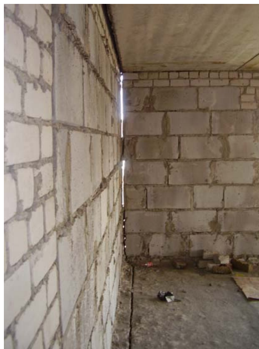
Рис. 4. Отрыв плит перекрытия от стен здания
