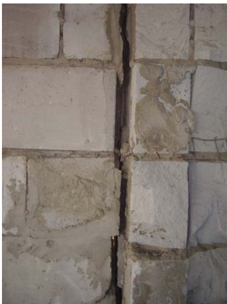
Рис. 5. Отрыв наружной и внутренней стен здания
