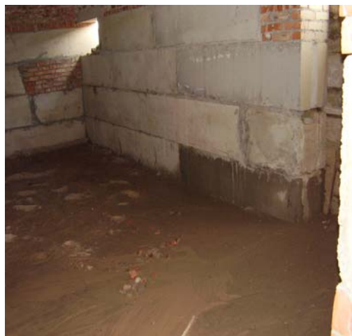
Рис. 6. Замоченный грунт в подвале здания
