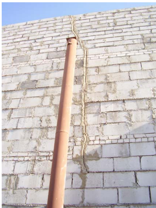
Рис. 2. Трещина на лицевом фасаде здания
