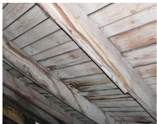
Рисунок 7 – Повреждение стропильной ноги
