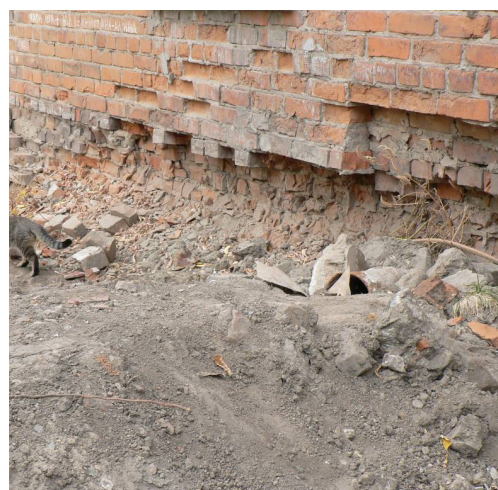
Рисунок 4 – Разрушение кладки стены по оси А в уровне цоколя
