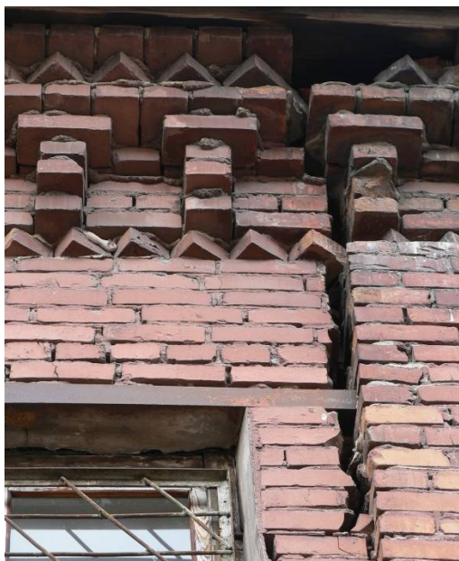
Рисунок 5 – Трещина в карнизной части наружной стены по оси 8 между осями В-Г
