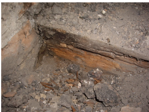
Рисунок 6 – Биологическое разрушение (гниение) материала балки перекрытия второго этажа (вид с помещения чердака)
