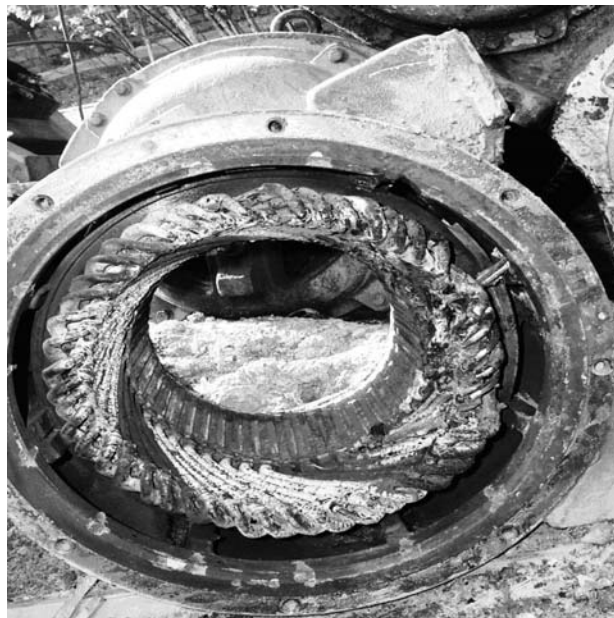
Рисунок 1 – Фрагмент повреждённой изоляции на лобовой части обмотки статора асинхронной машины
