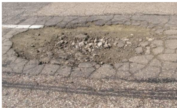
Рисунок 1 – Дефекты дорожного покрытия
