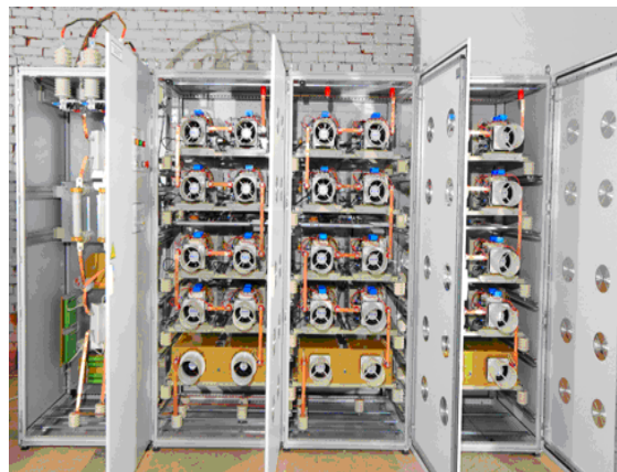
Рисунок 3 - Внешний вид компенсатора реактивной мощности и мощности искажений мощностью 250 кВА для распределительной сети 3,6/6 кВ
